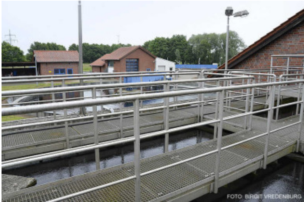
FIGURE 3.6.2.1 ZKA RIETBERG NAGESCHAKELDE GAK FILTERINSTALLATIE VOOR VERWIJDERING VAN MICROVERONTREINIGINGEN
