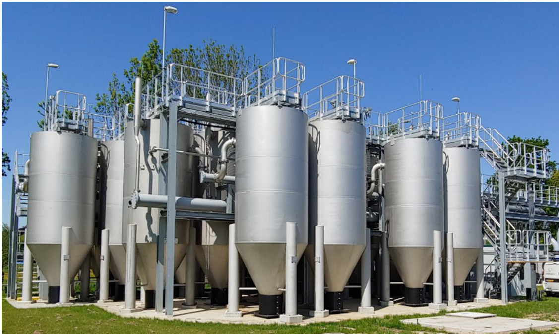
FIGUUR 2.1.5 NAGESCHAKELDE FILTERINSTALLATIE VOOR N EN P VERWIJDERING, RWZI WIJLRE (WBL)
